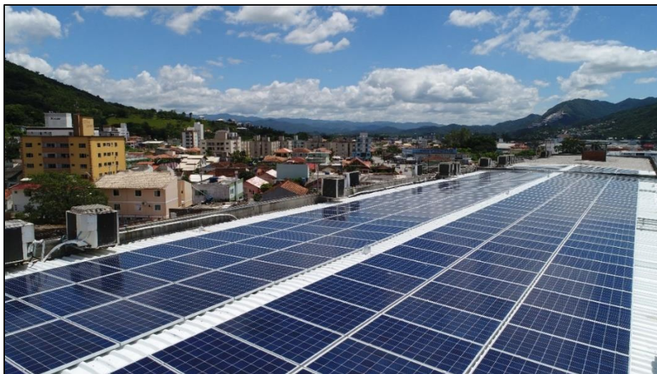
Imagem 1 – Painéis solares instalados no Campus Biguaçu
